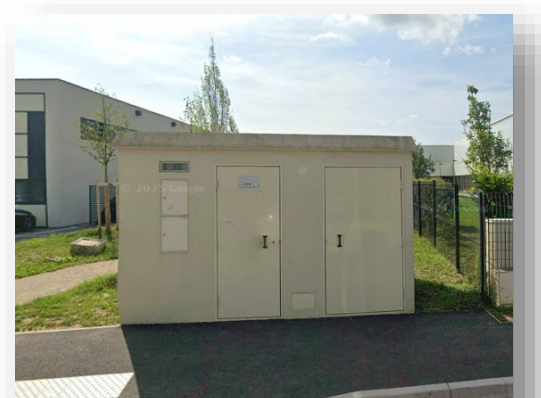
Poste de transformation de type UP à Gueux (Source Google maps)
