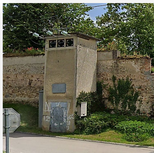
Poste Cabine Haute à Marcilly sur Seine (source Google maps)
