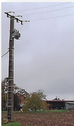
Poste H61 à Trefols (source Google maps)
