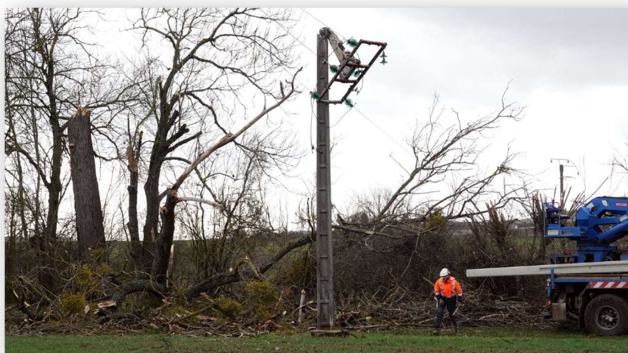
Support HTA brisé sous l'effet du vent (source internet)
