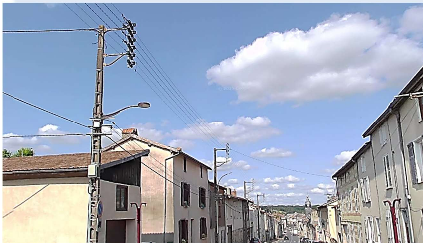
Réseau aérien fils nus à Sainte Menehould (source Google maps)
