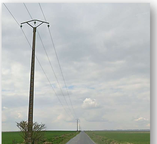
Ligne aérienne HTA suspendu entre Pleurs et Linthelles (source : Google maps)
