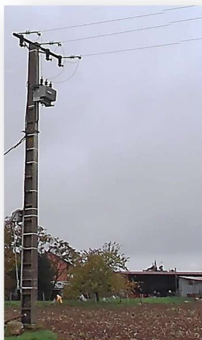
Poste H61 à Trefols (source Google maps)
