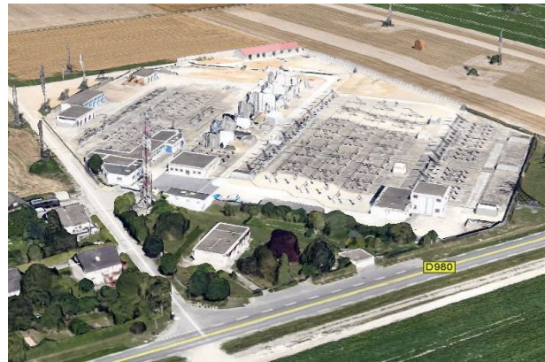
Le poste source « ORMES » (google EARTH)
